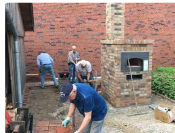
Der Bausatz wurde verbaut, der Klinker um den Ofen fertiggestellt, dadach wurden die Pflasterarbeiten ausgeführt. Juni 2019
