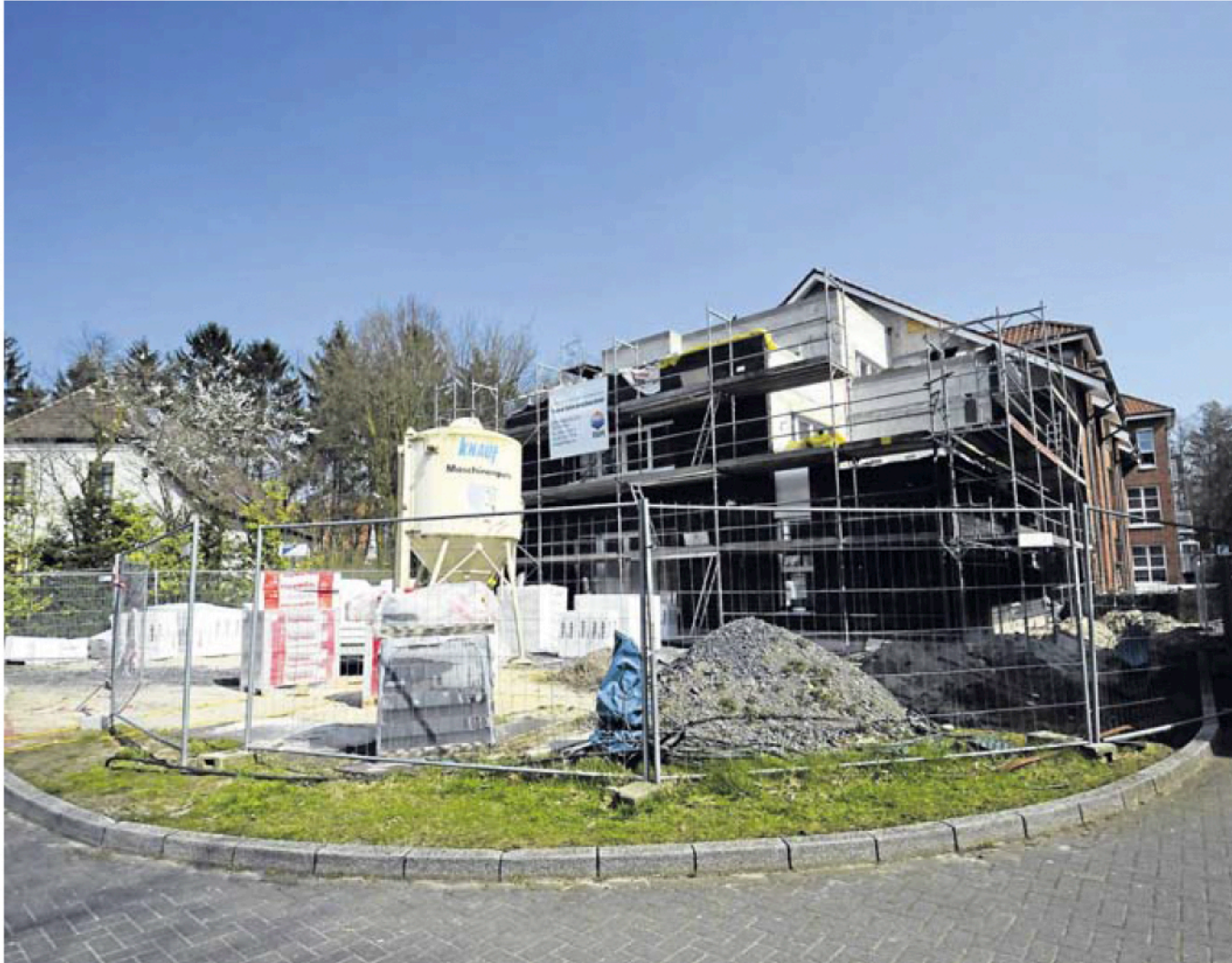
Noch steht ein Bauzaun, wo der Sinnesgarten für die Nutzer des neuen Anbaus am Henricus-Stift entstehen soll.
