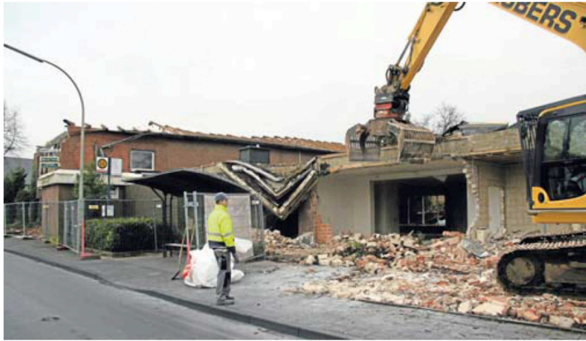
Das Flachdach brach nach kurzem „Antippen“ mit der Baggerschaufel zusammen. MLZ-Foto
