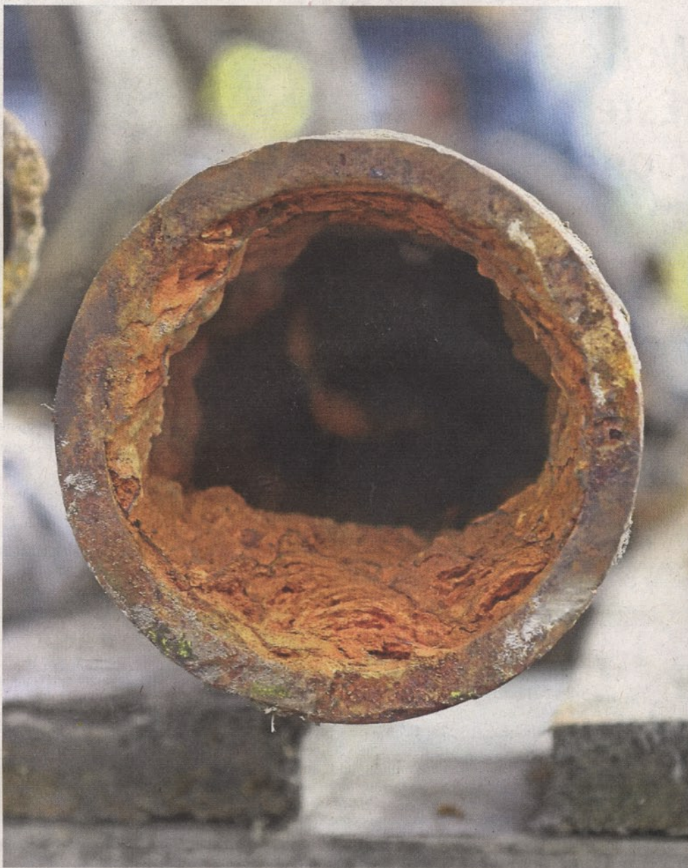
Defekte Abwasserleitungen belasten die Umwelt, können aber auch für Hausbesitzer teure Folgen haben.
