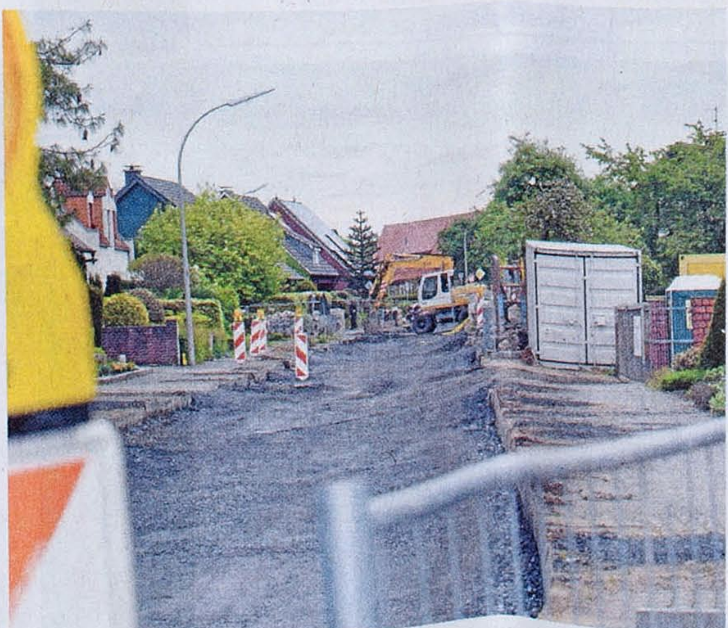
Die Arbeiten an der Eschlohrer Straße ziehen sich noch hin. Erst im Frühjahr 2011 soll die Straße fertig sein. MLZ-Foto Steur
